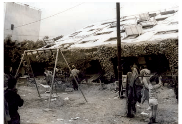
図-3.3 基礎部が現れた県営アパート(新潟市中央区川岸町)
