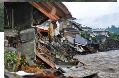
河岸侵食により家屋倒壊した状況
