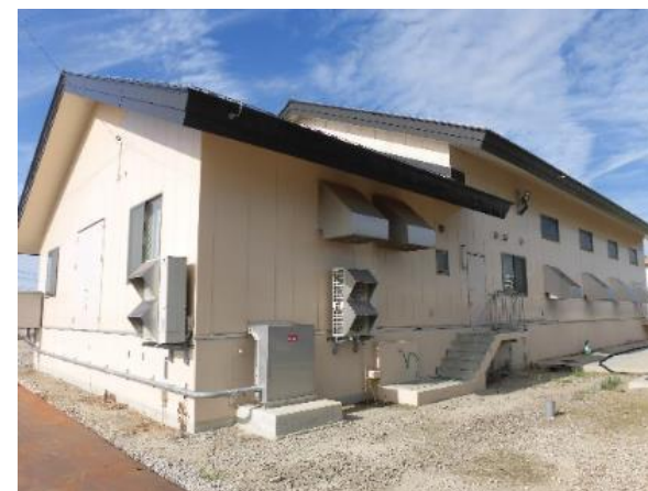
旧木山排水機場（新潟市）
