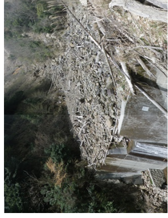
治山ダムが山腹崩壊と土砂流出を軽減した事例【大分県日田市】
