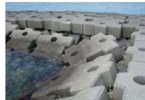
突堤の被覆ブロックの散乱事例
