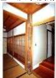
柱の洪水痕跡
