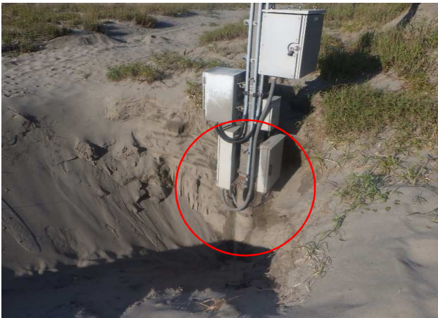
飛砂により埋没した設備
