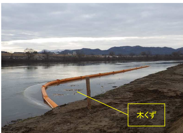
写真③(木くず等の流出防止)
