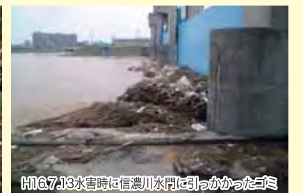
H16.7.13水害時に信濃川水門に引っかったゴミ
