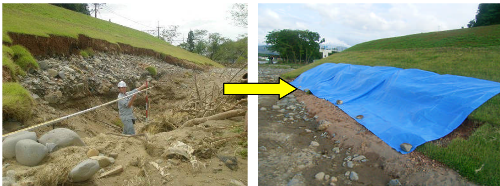
左岸No.127.5付近（魚沼市向山） 管理用通路法尻洗掘
