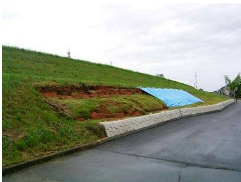
L19.4k 付近 六郷川裏法崩れ状況
