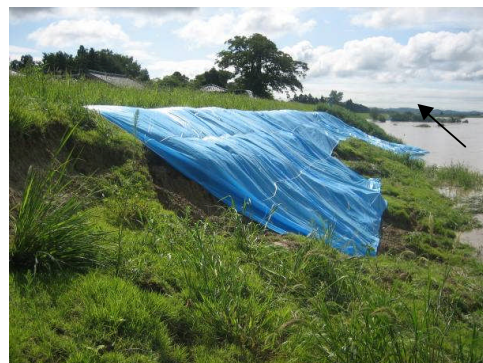
L29.2k 付近堤防川表法崩れ
