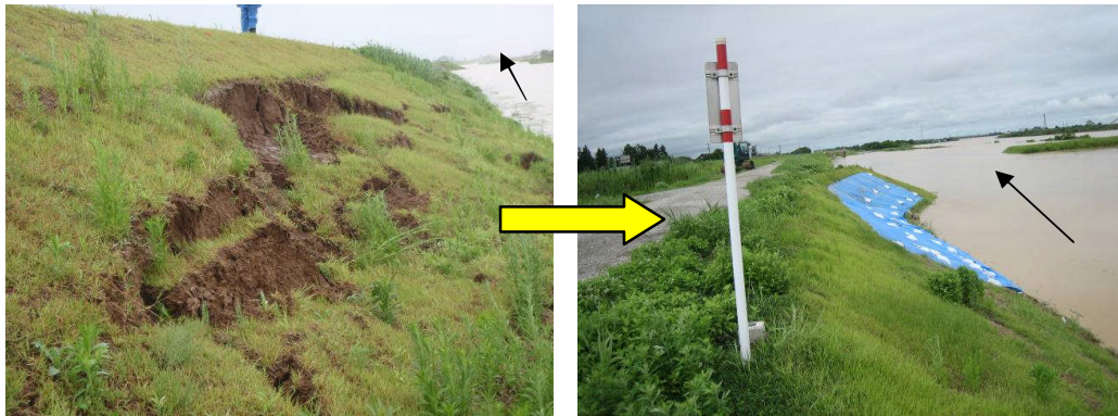
左岸1.0k（長岡市町軽井） 法崩れ
