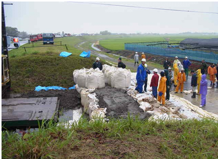
小須戸橋左岸（13日）
