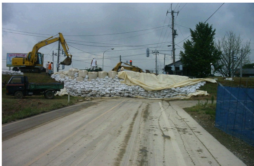
小須戸橋左岸（13日）
