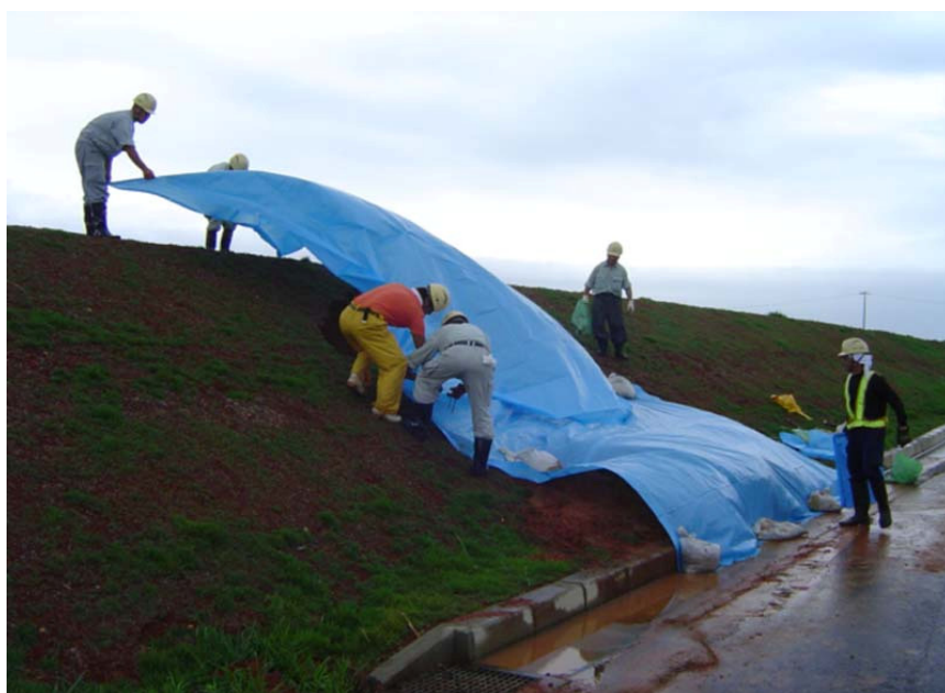
左岸9k付近（13日14時頃）
