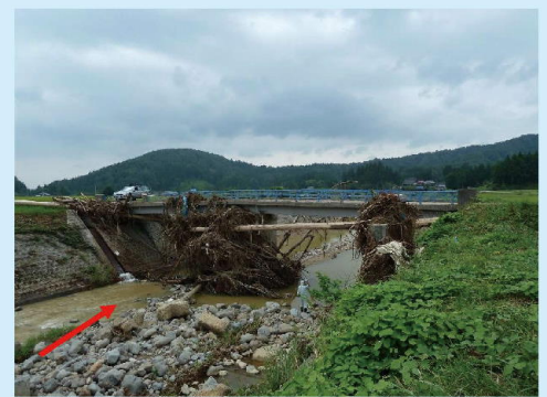
⑩ 巾ノ橋付近の被災状況(長岡市上塩)
