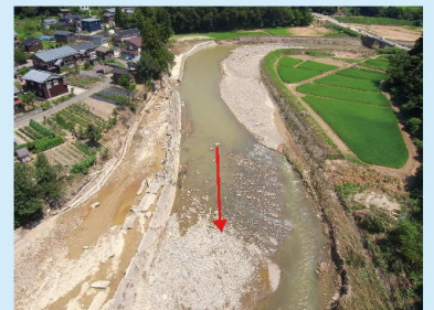
② 堤防欠壊地点の状況(長岡市人面)
