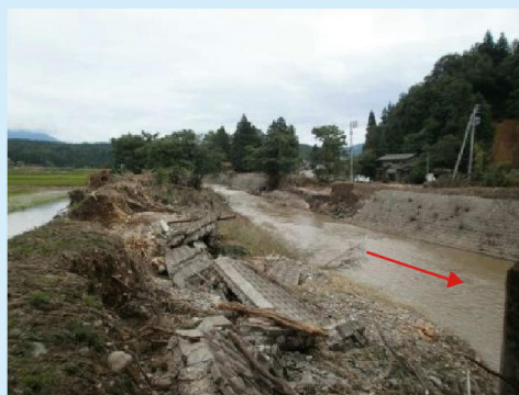
⑨ 堤防欠壊地点の状況(長岡市上塩)
