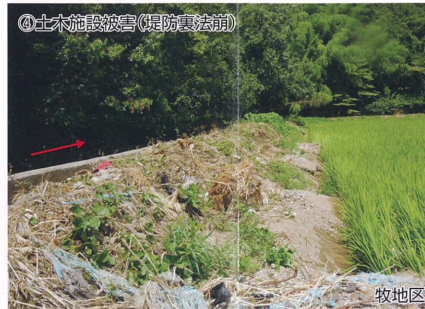
平成23年7月新潟・福島豪雨による牧川浸水状況
