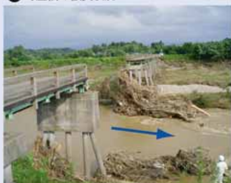
⑫ 町屋橋の被災状況
