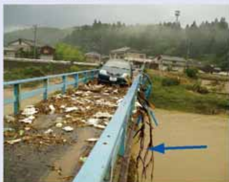
⑬ 桜明橋の被災状況
