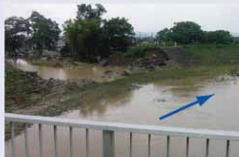
⑤ 破堤地点の状況 (中之島町中之島)
