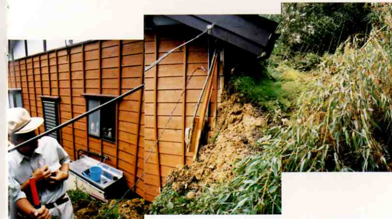
地すべりにより、新築間もない人家が被災した 二宮地区(佐渡郡佐和田町)
