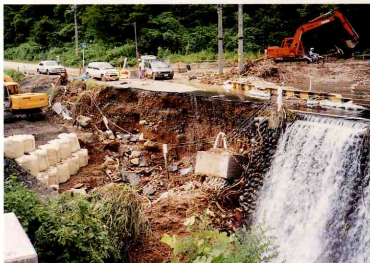
道路欠壊 国道252号(北魚沼郡入広瀬村大白川新田地内)
