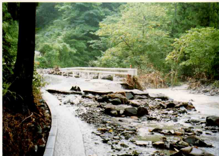
道路欠壊 県道赤玉両津港線(両津市下久知地内)
