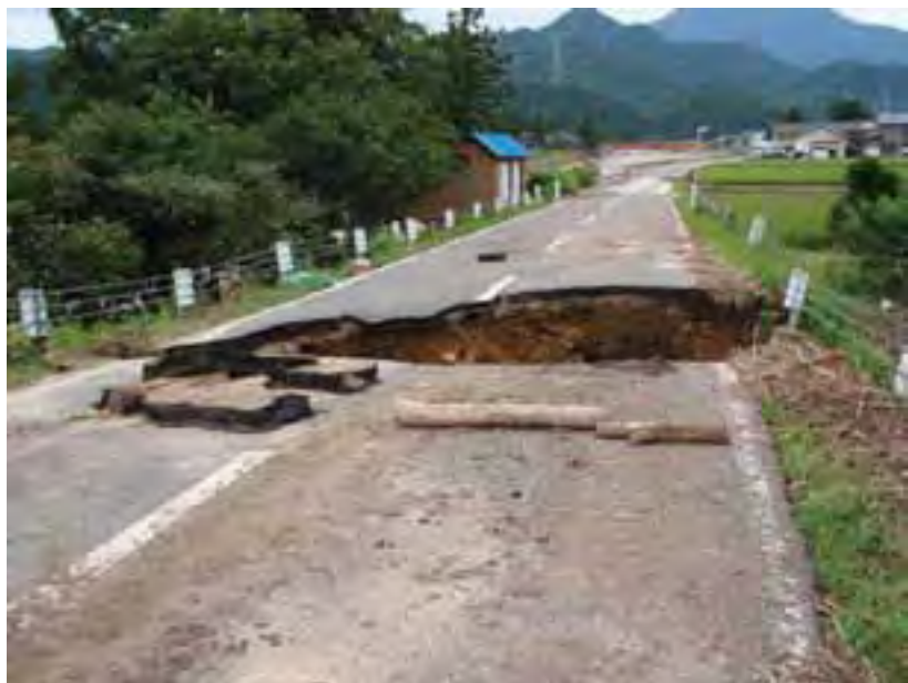
【写真左】 国道289号の被災状況 撮影地 三条市棚鱗地内
