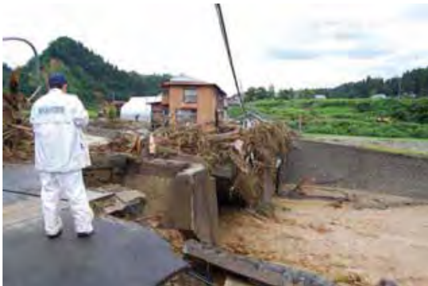
【写真左】 県道十日町塩沢線 六箇橋の被災状況 撮影地 十日町市中村地内
