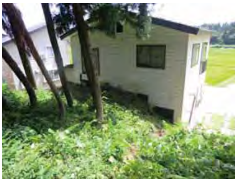
【写真左】 民家の被災状況 撮影地 魚沼市君帰地内
