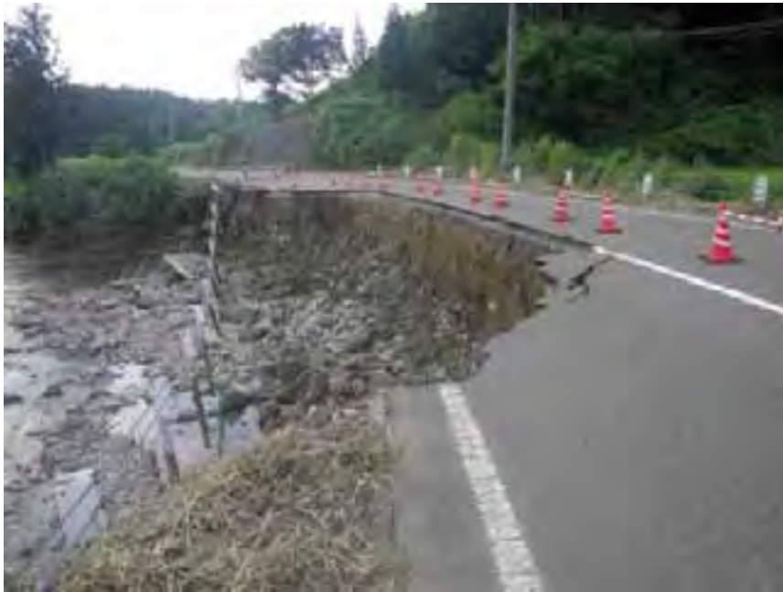
【写真左】 県道上塩枳尾線の被災状況 撮影地 長岡市枳尾本所地内
