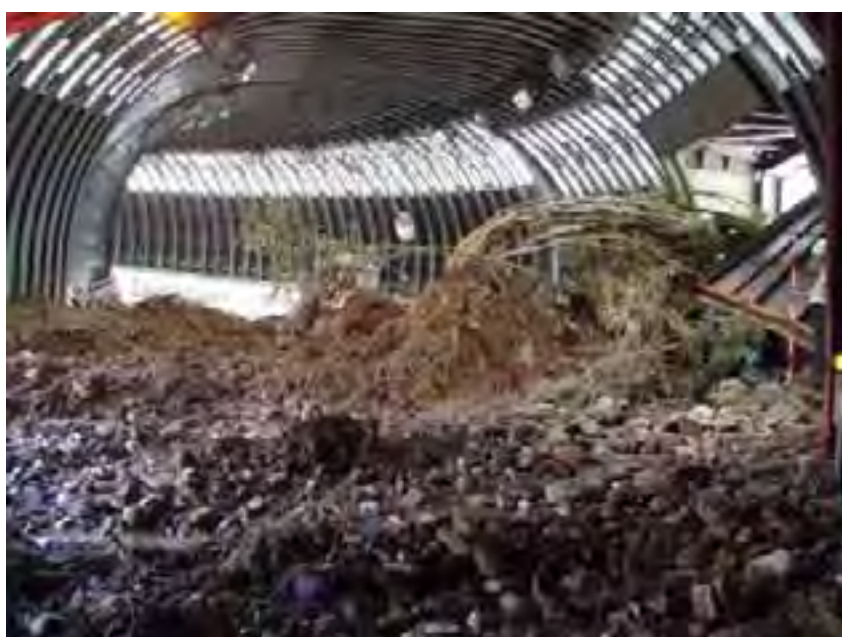
【写真左】 国道253号 小栗山スノーシェルターの被災状況 撮影地 南魚沼市余川
