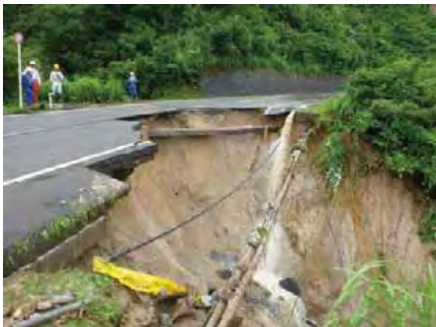
【写真左】 県道小出奥只見線 奥只見シルバーラインの被災状況 撮影地 魚沼市下折立地内
