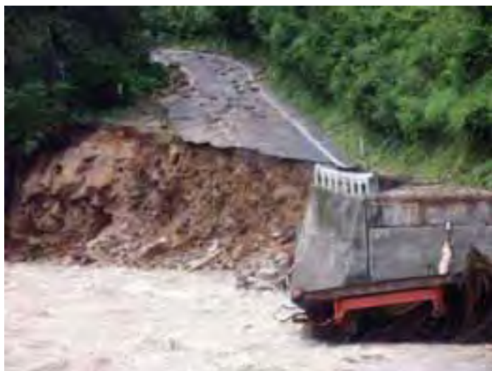
【写真左】 国道352号 獅撫沢橋の被災状況 撮影地 魚沼市下折立地内
