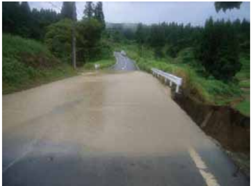
【写真右】 県道小千谷大和線の被災状況 撮影地 小千谷市冬井地内
