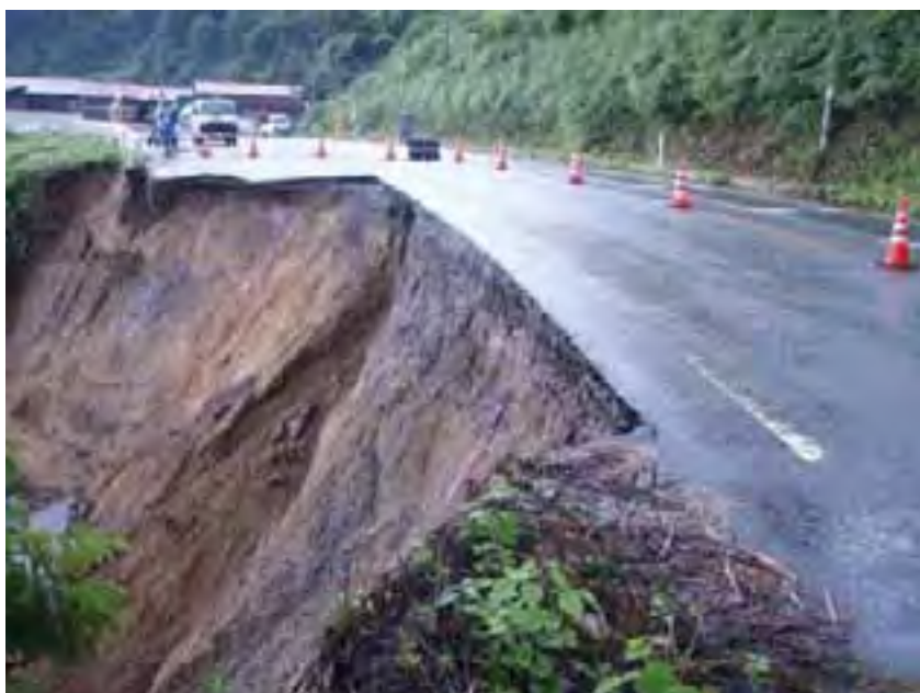
【写真左】 国道252号の被災状況 撮影地 柏崎市高柳町岡田地内
