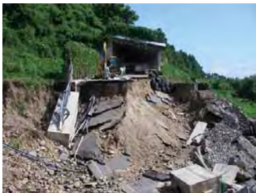
【写真右】 県道小千谷十日町津南線の被災状況 撮影地 十日町市千手地内
