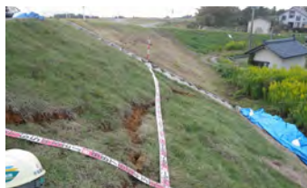
堤防に入った亀裂の確認状況
