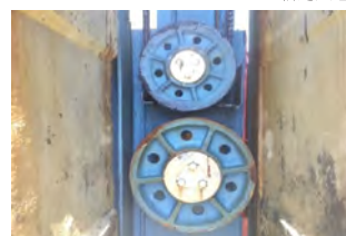
ゲートローラ部の劣化
