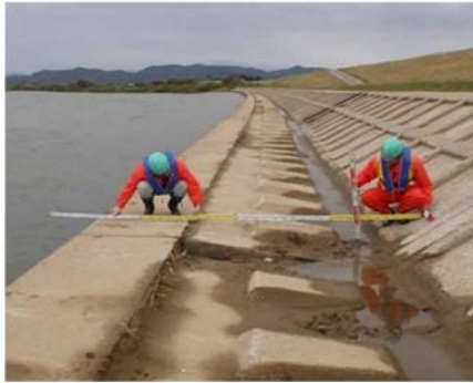
小段平張沈下、隔壁陥没 (R3. 12)
