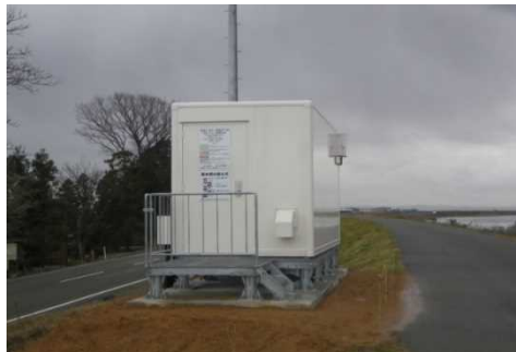
水位観測局舎
