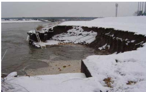
被災直後（平成 18 年 3 月 3 日）
