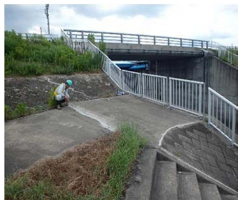
才歩川水門取付堤防護岸不同沈下
