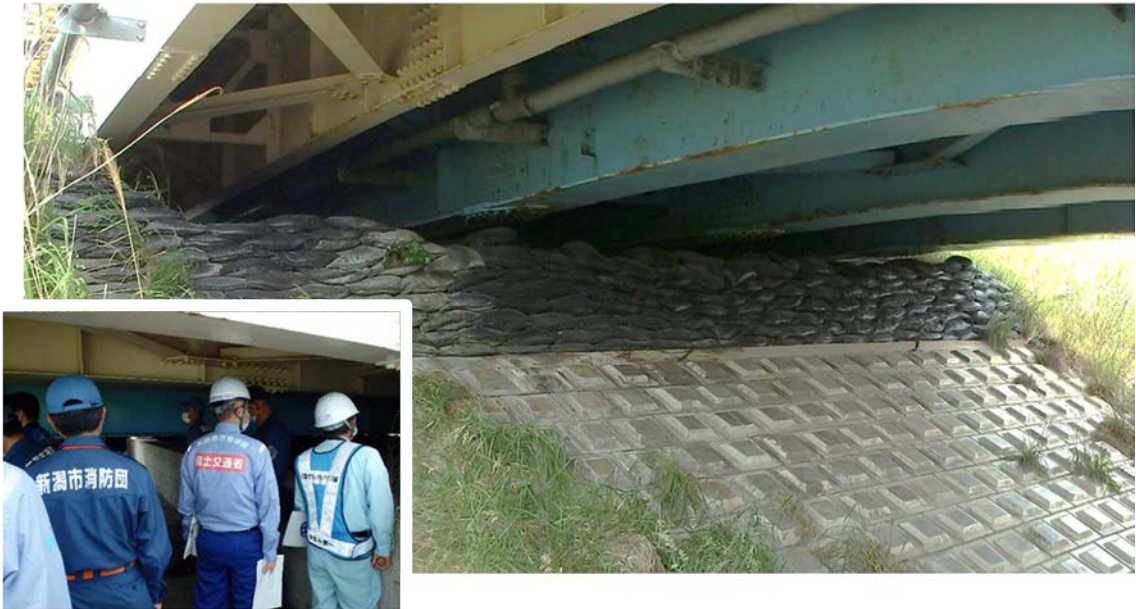
信濃川大橋左岸特殊堤川裏土のう積み（R3年6月重要水防箇所合同巡視）
