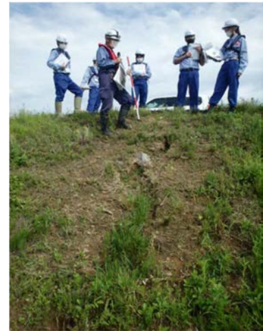
天神地先川表坂路での法面侵食
