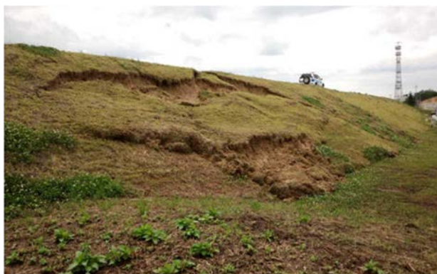
平成 29 年 7 月強降雨による善久地先川裏法崩れ
