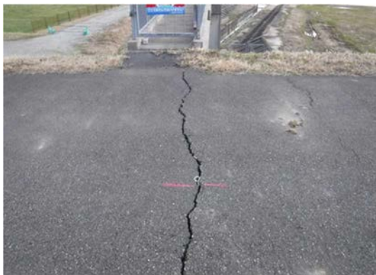
赤浜取水樋管天端舗装クラック
