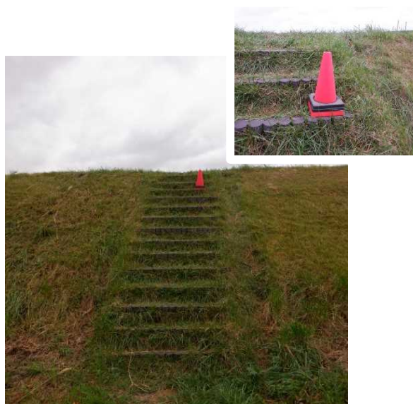
川裏階段ステップ陥没
