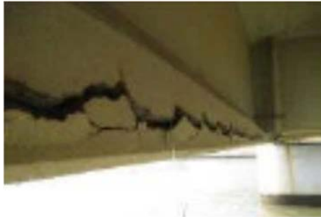
主桁の損傷状況
