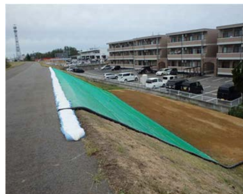
善久地先川裏法崩れ箇所での補修 (枕土のうとシート張法面養生による雨水侵食対策 同年 10 月撮影)
