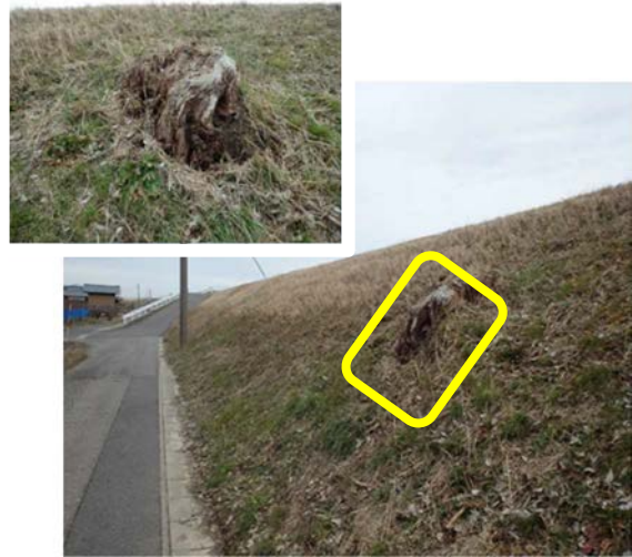
堤防裏小段法面上の残存木根
