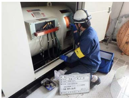
【信濃川水門】 ガスタービン発動発電機動作点検
