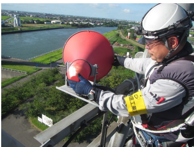
放流警報設備
