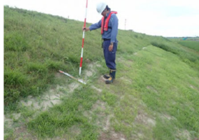
はらみ出し箇所の確認
