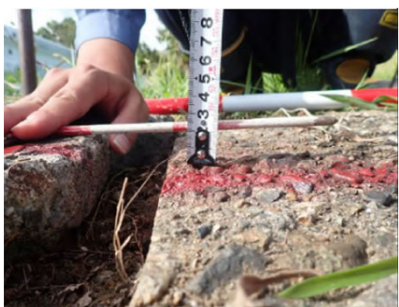
変状モニタリング
