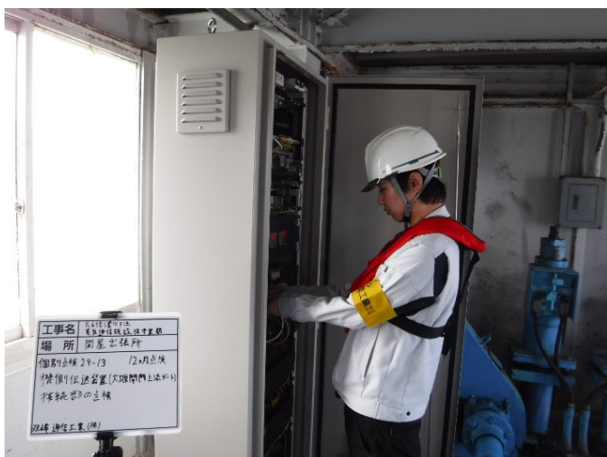
ゲート用機側伝送装置
