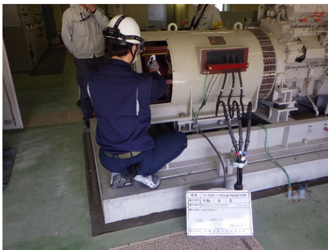
非常用発動発電機
