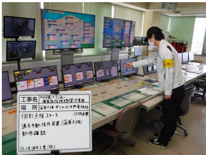
堰管理用制御処理設備
