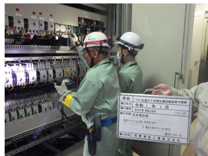
高圧受変電設備
