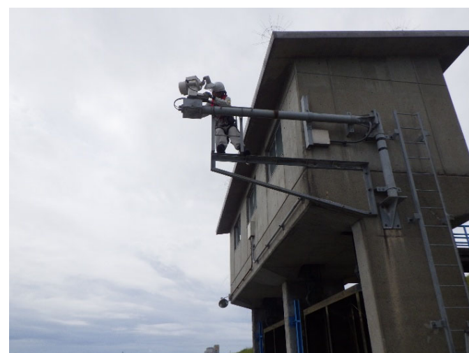
CCTVカメラ設備
