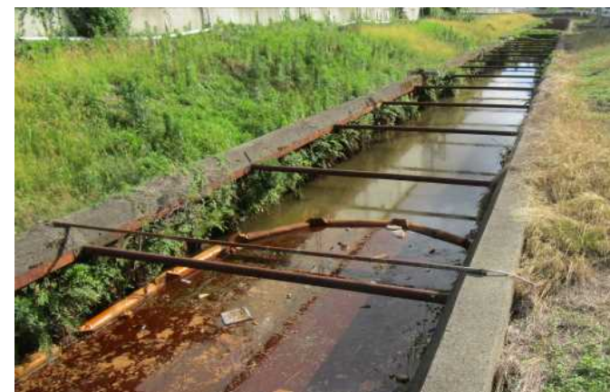
オイルフェンスにより、下流に油類が流れ出るのを防いでいる様子
