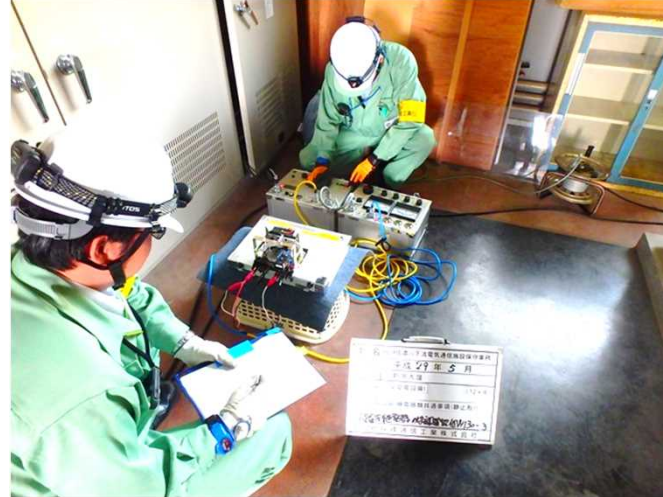
【関屋出張所】 受変電設備(継電器類共通事項(静止形))点検
