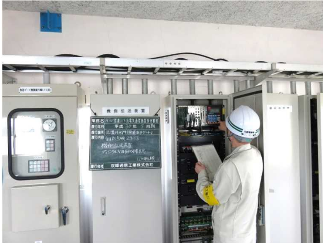
【信濃川水門】 機側伝送装置点検
