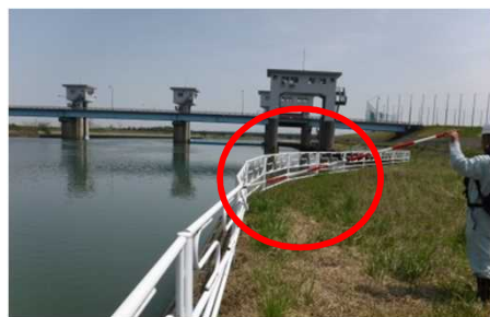
蒲原大堰右岸 転落防止柵曲がり
