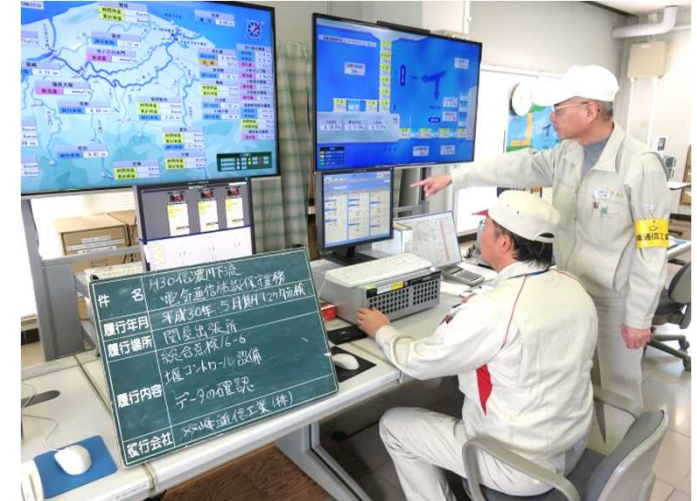
【関屋出張所】堰コントロール設備データ確認
