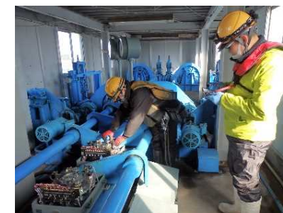
新潟大堰ゲート巻上装置点検
