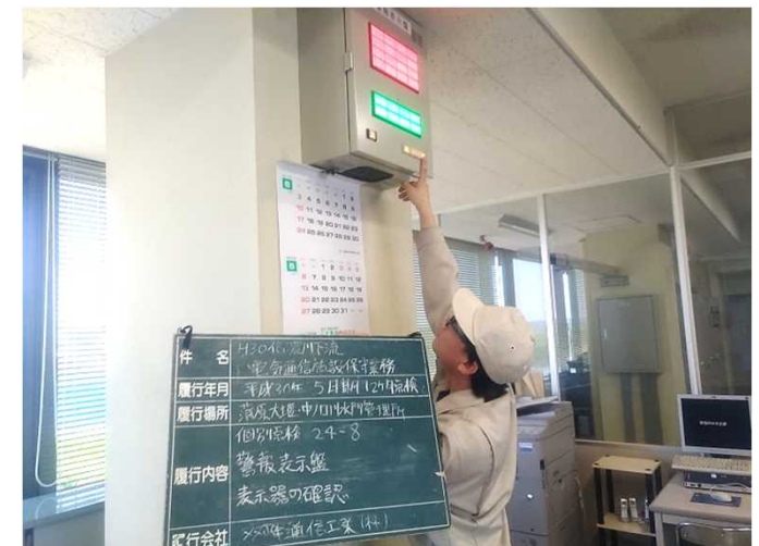
【蒲原大堰・中ノ口川水門管理所】 警報表示板表示器の確認
