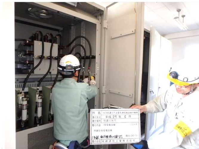
【信濃川水門】 受変電設備(閉鎖配電盤)点検
