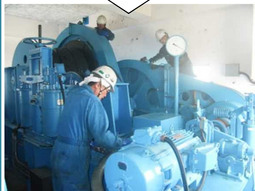
新潟大堰 主ゲート開閉装置点検
