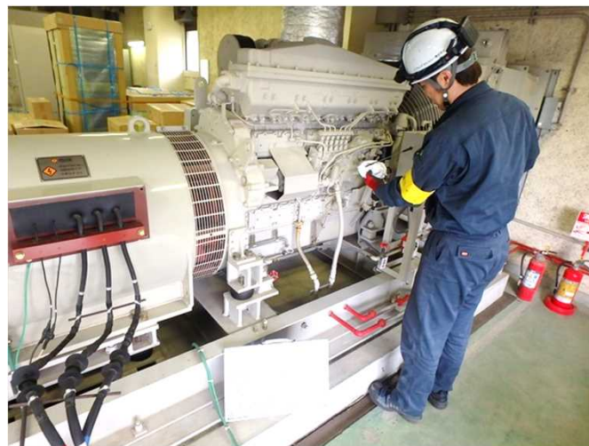
【蒲原大堰・中ノ口川水門管理所】 発動発電機(ディーゼル)(原動機)点検
