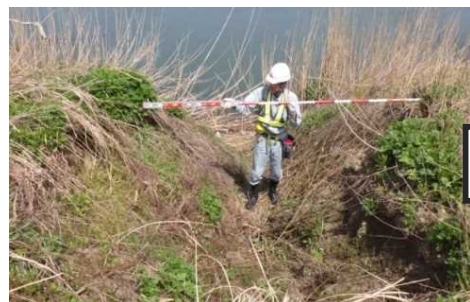
信濃川右岸 河岸土砂崩壊
