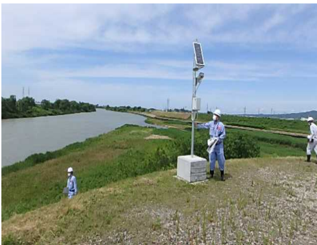
簡易型河川監視カメラの設置状況を確認 【加茂川合流点】
