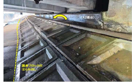
【写真⑩】護岸ブロックの変状(A2橋台 前面)
