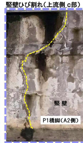
【写真⑨】P1橋脚 A2側正面 堅壁ひび割れ(上流側_c部)
