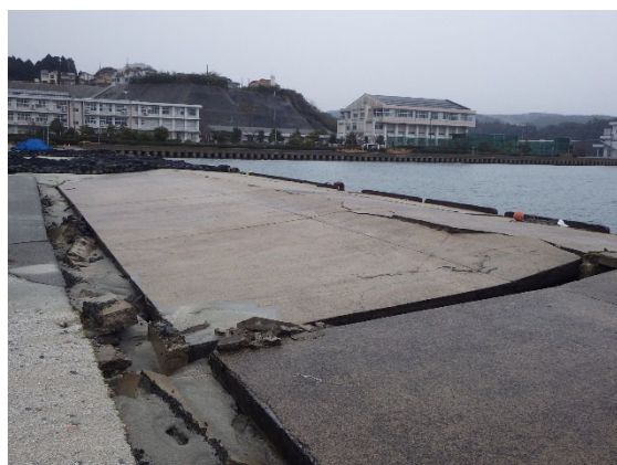
13号物揚場 被災状況
