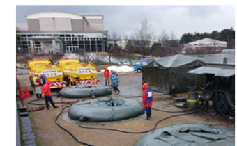
東北地整(七尾市) (自衛隊入浴施設給水)
