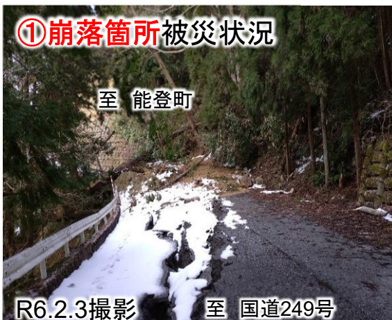
県道26号の被災状況
