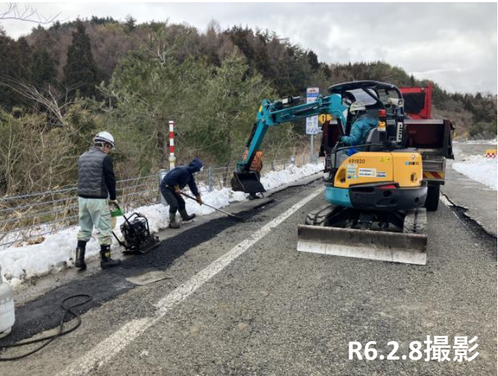
No.4付近 亀裂・段差補修状況
