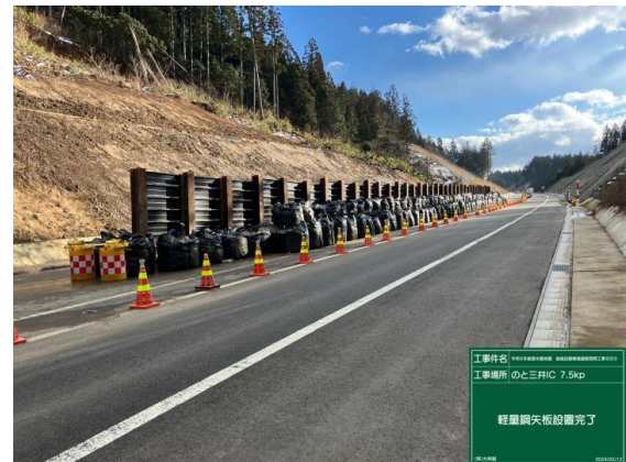
写真3. 能越自動車道(輪島道路)の矢板防護工
