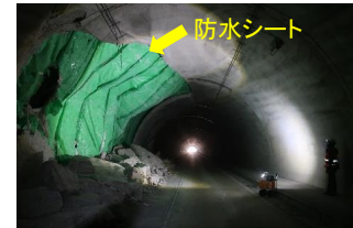
写真3. B区間崩落状況
