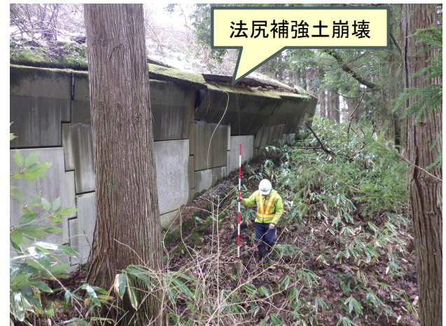
写真4. 七海2号橋A1橋台付近盛土法尻補強土の被災状況
