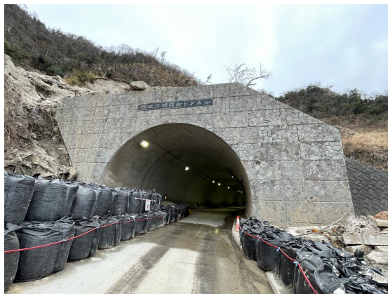
写真4. 八世乃洞門珠洲側坑口部の斜面崩壊
