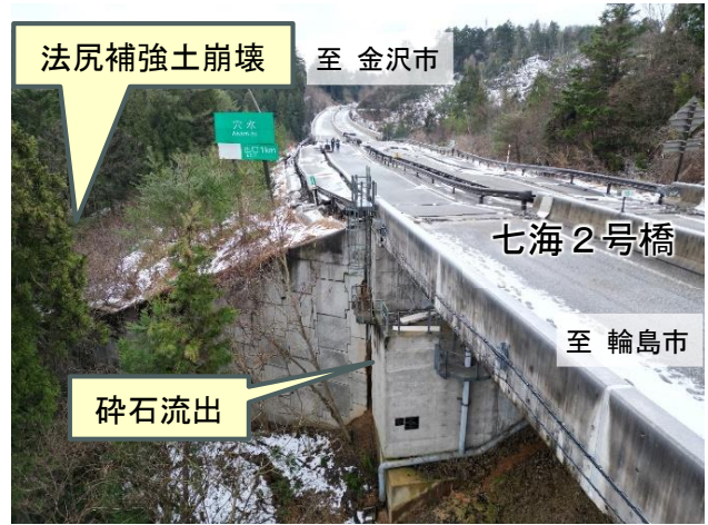
写真3. 七海2号橋A1橋台付近の被災状況
