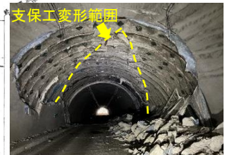
写真4. C区間崩落状況
