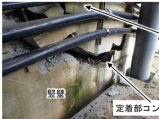
写真2. 変位制限構造の損傷状況（能登大橋）
