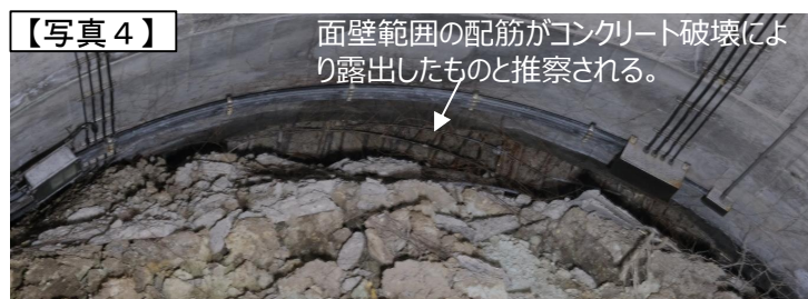
写真 4. 輪島側坑口閉塞部の天端鉄筋露出状況
