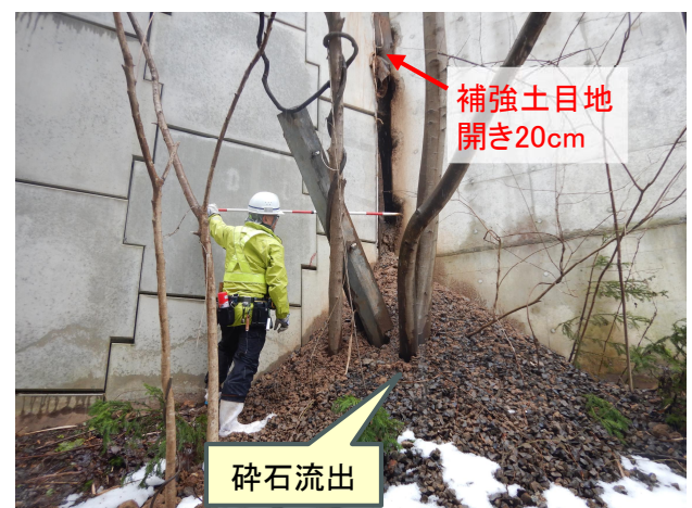
写真5. 七海2号橋A1橋台補強土の被災状況
