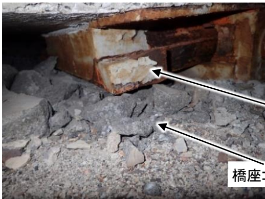
写真1. 支承部の損傷状況（能登大橋）
