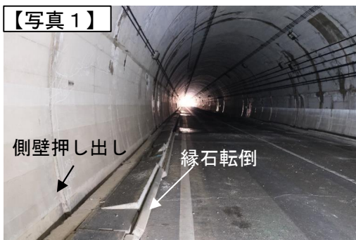
写真 1. 側壁押し出し、縁石転倒
