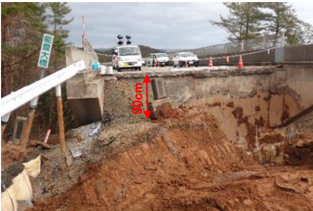
写真2. 能登大橋A1橋台アプローチ部の被災状況
