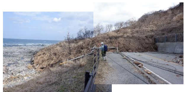
写真2. 千枚田地区崩落土塊
