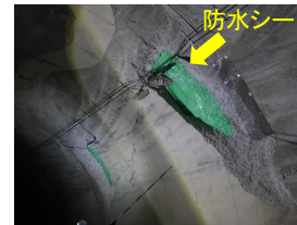
写真2. A区間崩落状況
