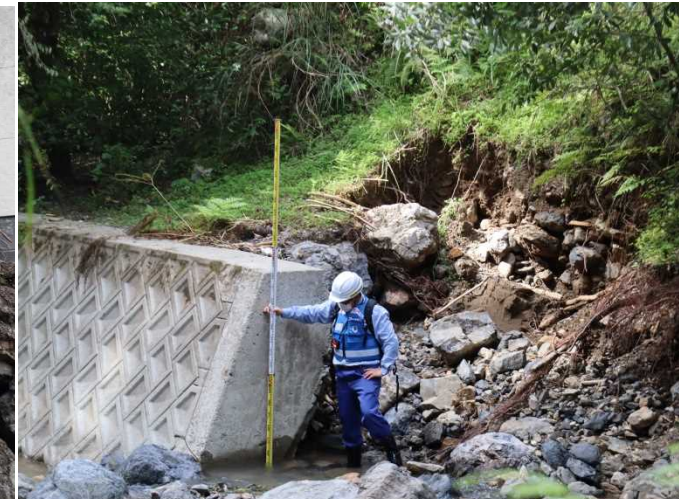
伊高瀬地先 現地状況 (溪岸の侵食状況)
