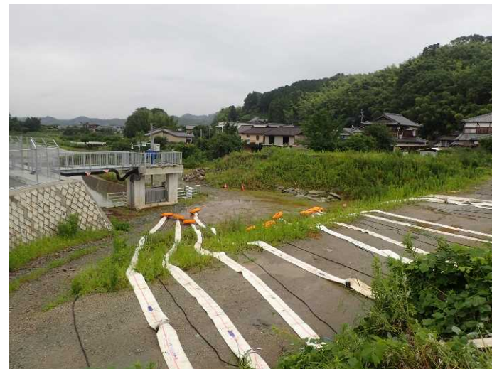
④矢部川(北山地区)排水機場 (排水ポンプ設置状況確認)
