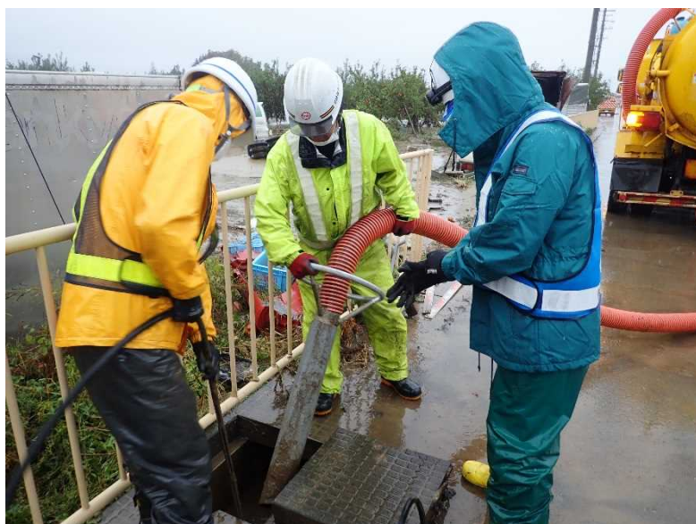
側溝清掃（国道18号 長野市大字赤沼） 土砂をジェット水流でかき出し、バキューム
