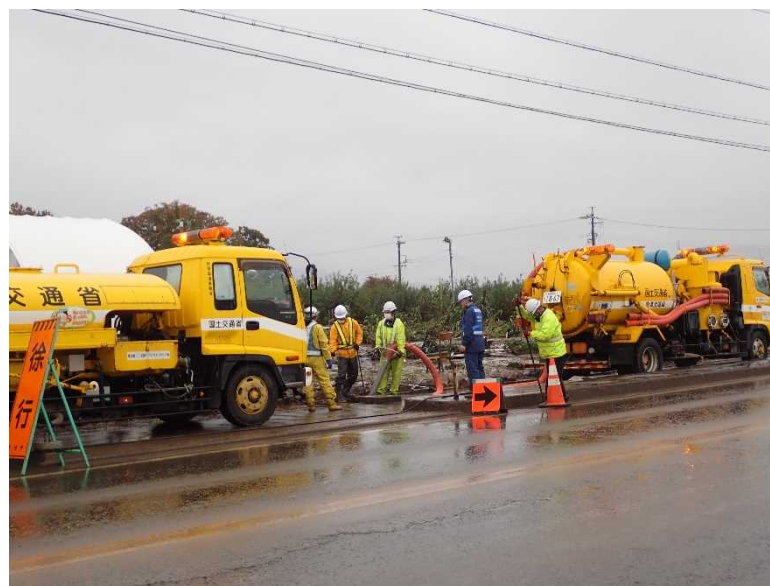
側溝清掃（国道18号 長野市大字赤沼） 土砂をジェット水流でかき出し、バキューム
