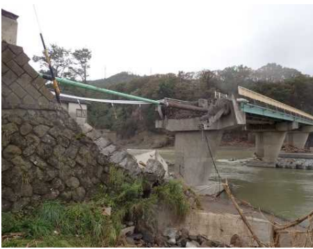
田中橋 被災状況
