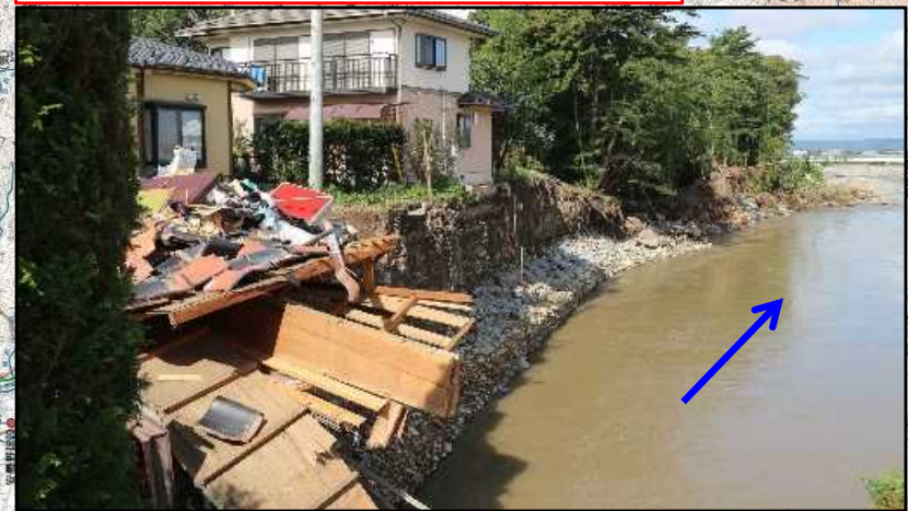
【千曲川：護岸崩壊】 長野県 佐久市 原 地先～佐久穂町 高野町 地先
