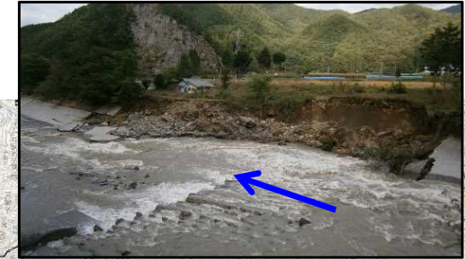
【千曲川：護岸崩壊】 長野県 小海町 千代里 地先～東馬流 地先
