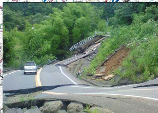
国道8号 長岡市大積千本 光ケーブル切断
