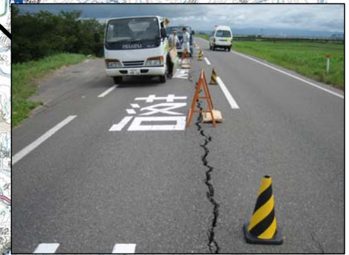
信濃川大河津分水路 燕市野中才(のなかさい) 堤防上面亀裂 L=300m
