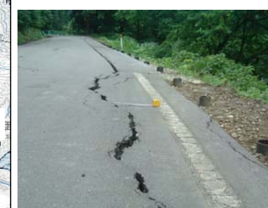
野生ゾーン連絡路損傷
