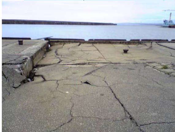
中央ふ頭 岸壁(-5.5m) エプロン部陥没 ＜供用不可＞
