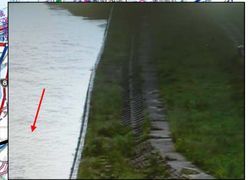
信濃川下流 燕市道金(どうきん) 護岸矢板傾倒 L=140m
