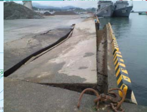
中浜ふ頭3号岸壁 東側端部の取付護岸海側に傾き ＜救援物資に荷役は可能＞
