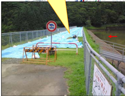
柏崎市上水道 柏崎市川内(こうち) 川内ダム天端クラック発生
