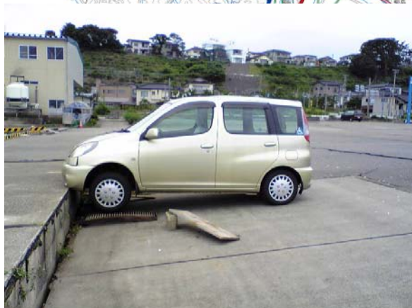
中央ふ頭 1号物揚場(-4.0m) エプロン部陥没 ＜供用不可＞
