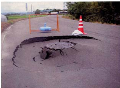
マンホール13箇所陥没(応急処理済)
