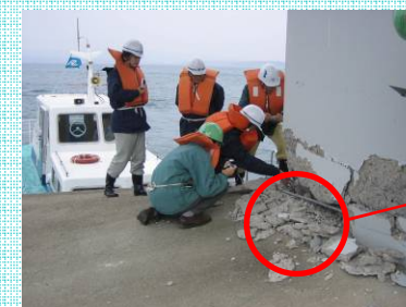
橋脚の基部が損傷
