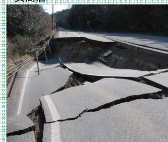
国道249号 道路崩落で全面通行止 (志賀町深谷)
