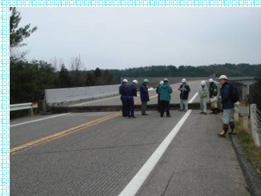
ジョイント部に段差発生
