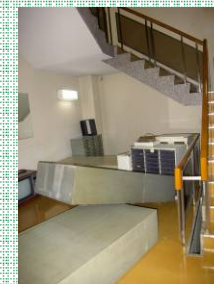
輪島市役所門前庁舎内の被災状況
