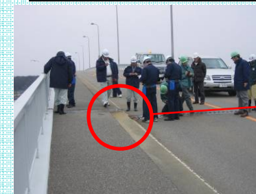
橋面のジョイント部が損傷
