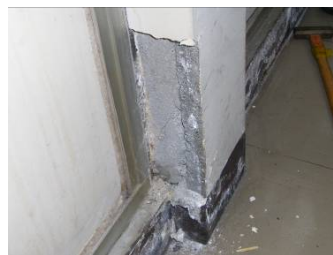
内装材の欠損
