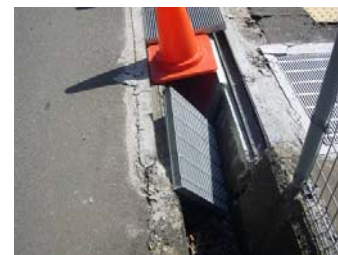
グレーチングの外れ
