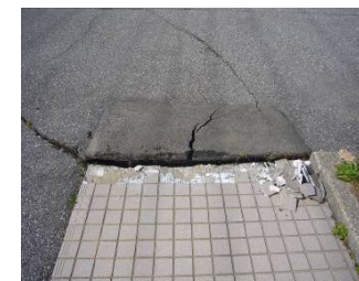
舗装の亀裂、タイルの破損
