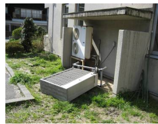
空調屋外機の転倒
