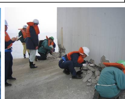
橋脚の基部が損傷
