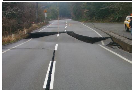
全面にわたり道路が陥没(3/29 6:00片交)
