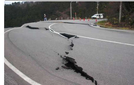
路面に亀裂、谷側の道路が陥没(3/29 6:00片交)
