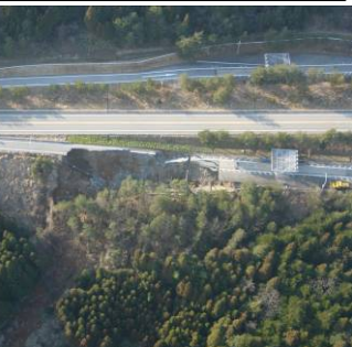
インターチェンジが崩落
