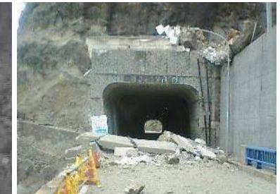
崖崩れにより洞門が損傷。谷側に倒れるように変形しているのが分かる。
