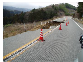
下り側車線の崩落
