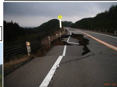
片側車線が崩落
