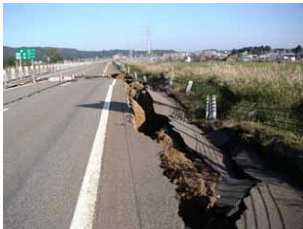
関越道(小千谷IC～川口IC) 路肩崩壊 (H16.10.24 撮影)
