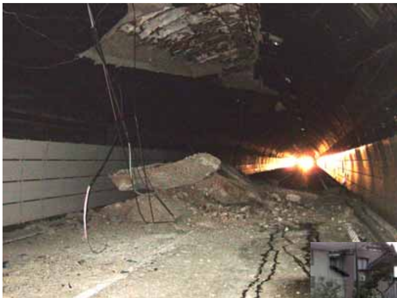
わなづ 国道17号 川口町和南津トンネル コンクリートの剥落 (H16.10.24 撮影)
