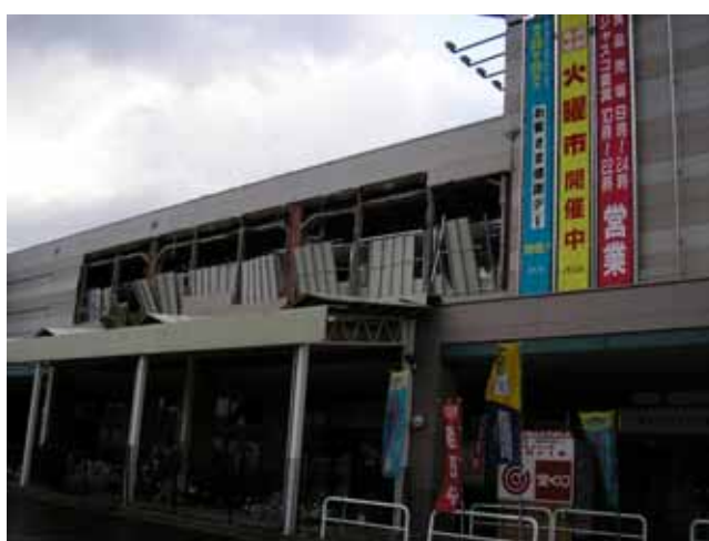
小千谷市平沢 ジャスコ小千谷店はがれ落ちた外壁 (H16.10.25 撮影)
