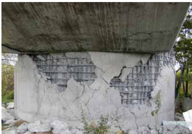
国道17号 小千谷大橋 橋脚コンクリート剥落 (H16.10.25 撮影)
