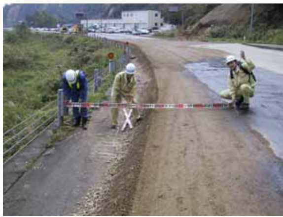
国道17号 和南津 応急復旧 (H16.10.25 撮影)
