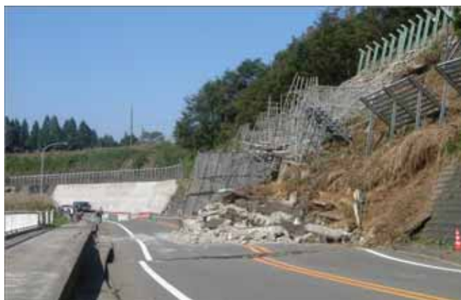
国道17号 川口町牛ヶ島 のり面崩落・亀裂 (H16.10.24 撮影)
