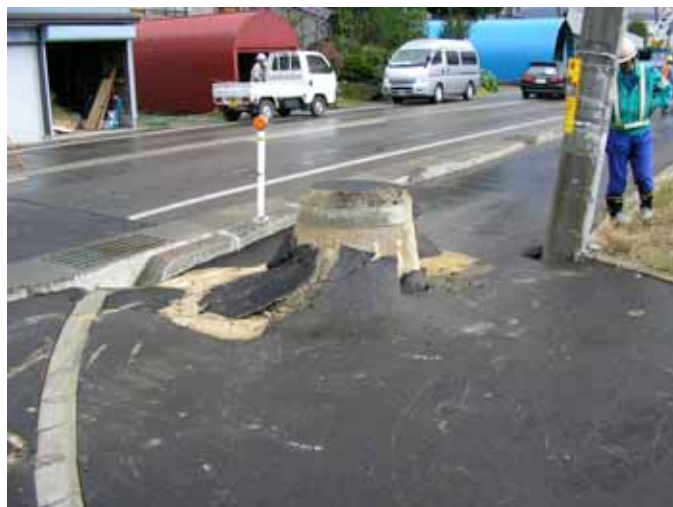
小千谷市桜町 突き出たマンホール、下水道も寸断 (H16.10.25 撮影)
