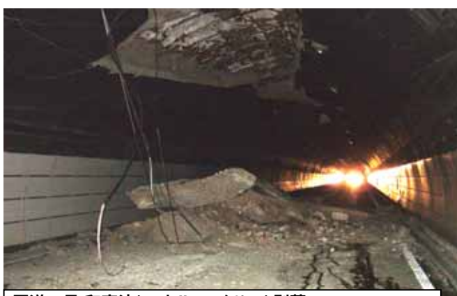
国道17号 和南津トンネルコンクリート剥落 (H16.10.24 撮影)
