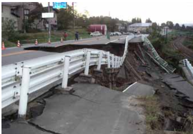
国道17号 川口町天納 道路崩壊 (H16.10.24 撮影)
