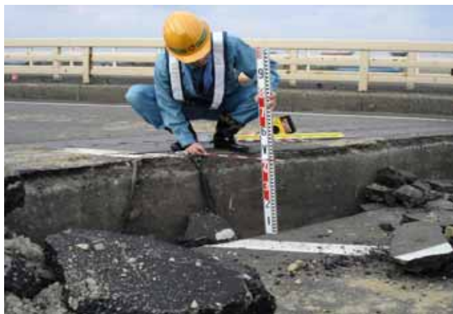
国道8号 見附大橋 段差 (H16.10.25 撮影)
