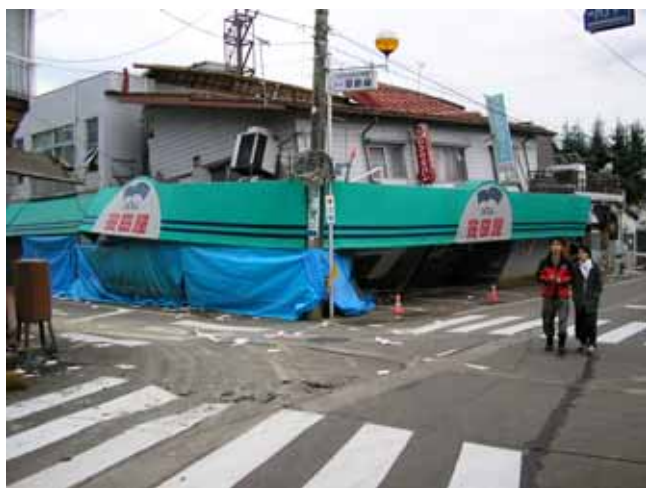
越後川口駅前 一階部分が潰れた店舗 (H16.10.25 撮影)
