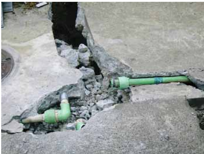
水道管が切断 (H16.10.25 撮影)
