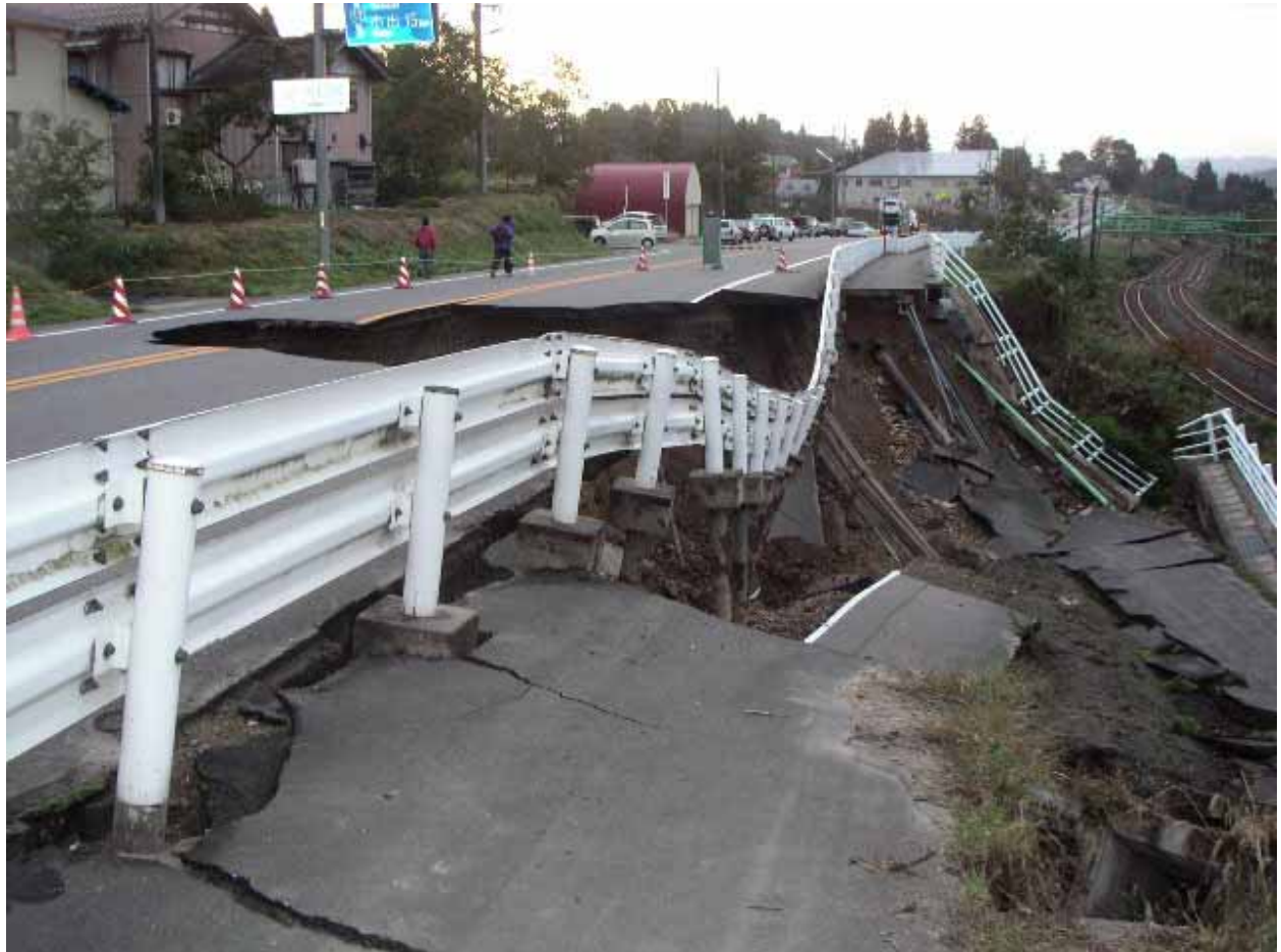
一般国道 17 号 川口町大字天納地先 道路崩壊状況
