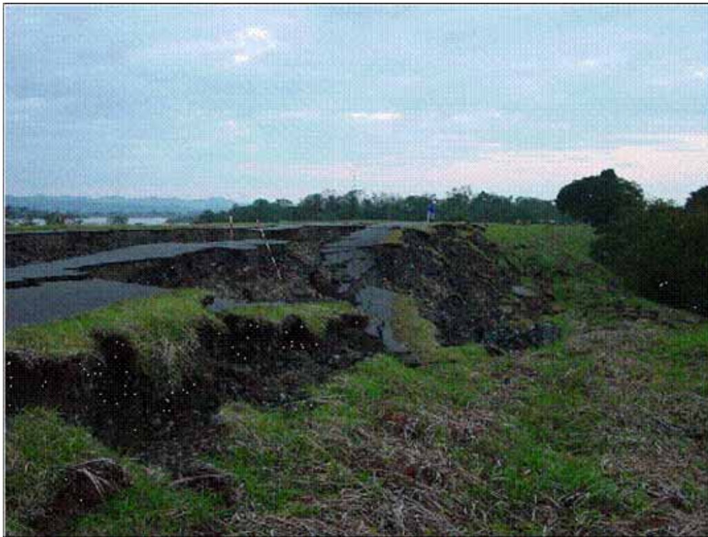
信濃川(右岸 29.1 ~ 29.25km)における裏法崩れ状況 24 日午前 8 時頃
