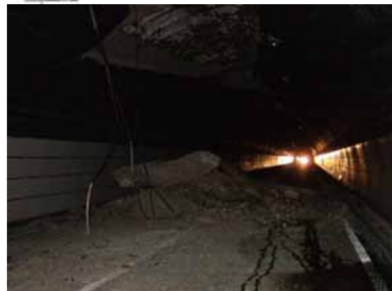
写真 - 1 コンクリート剥落の状況
