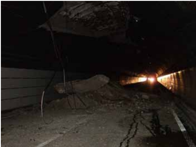
トンネルの巻立コンクリートが剥離し、崩落した状況
