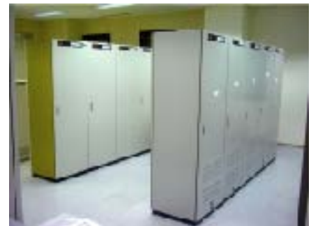
向こう側が現ダムコン処理装置 手前側が未だ動いていない新ダムコン処理装置 (平成17年12月工事中)
