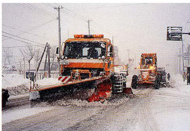
除雪トラック（広幅員除雪装置）+ 除雪グレーダによる雁行除雪作業
