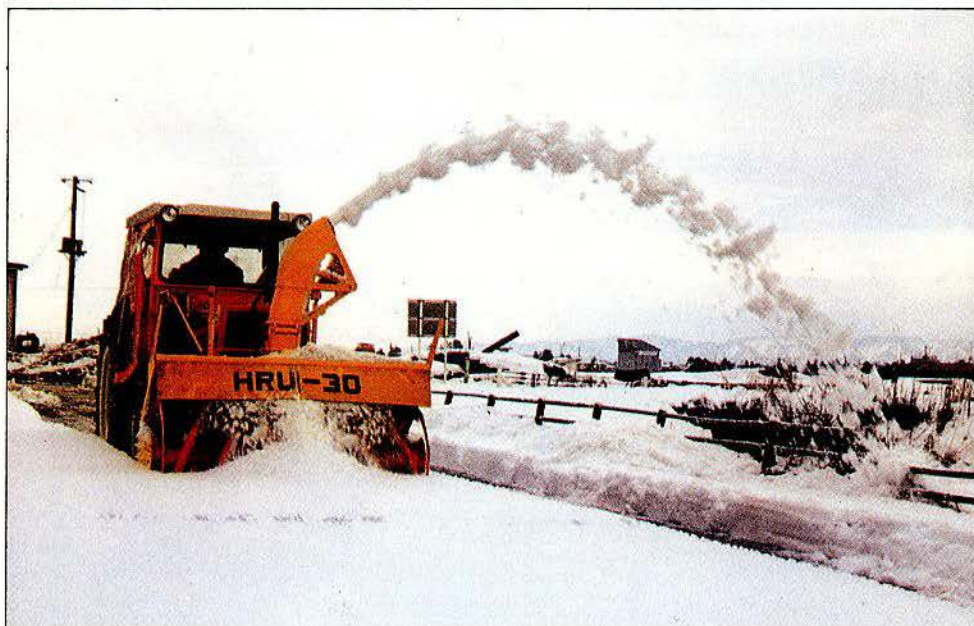
ロータリ除雪装置による 全幅除雪
