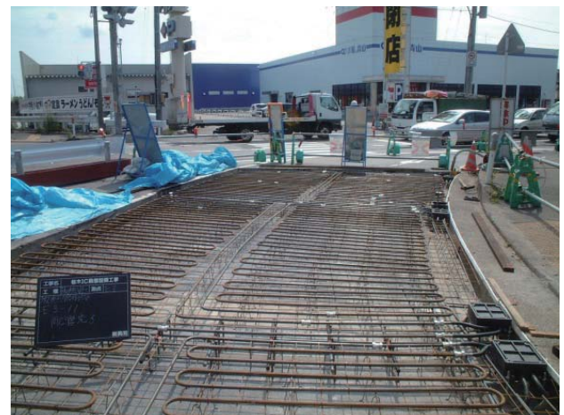
③放熱管設置状況
