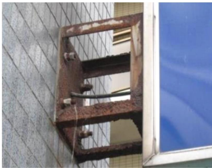
支持金具の腐食による落下の危険のある看板
