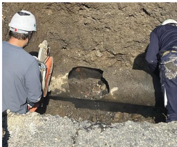
敷設後60年以上が経過し、老朽化によって破損した水管
