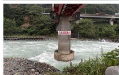
〈P1橋脚 洗掘状況〉
