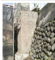
〈A2橋台 損傷状況〉
