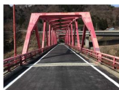
〈トラス部 腐食状況〉
