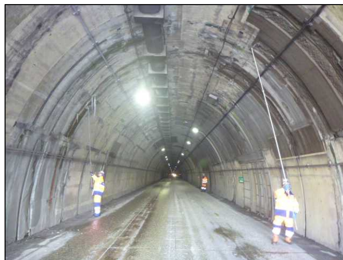
氷柱処理【国道17号 新潟県湯沢町】 (R1.12.25撮影)
