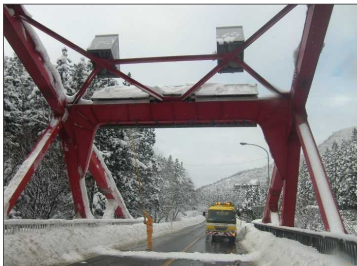
トラス橋着雪処理【国道113号 新潟県岩船郡関川村】 (H28.1.13撮影)
