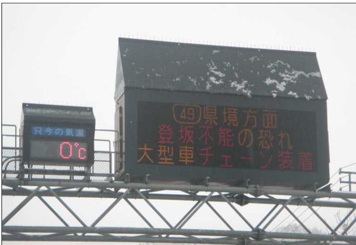
道路情報板【国道49号 新潟県東蒲原郡阿賀町】 (H28.1.10撮影)
