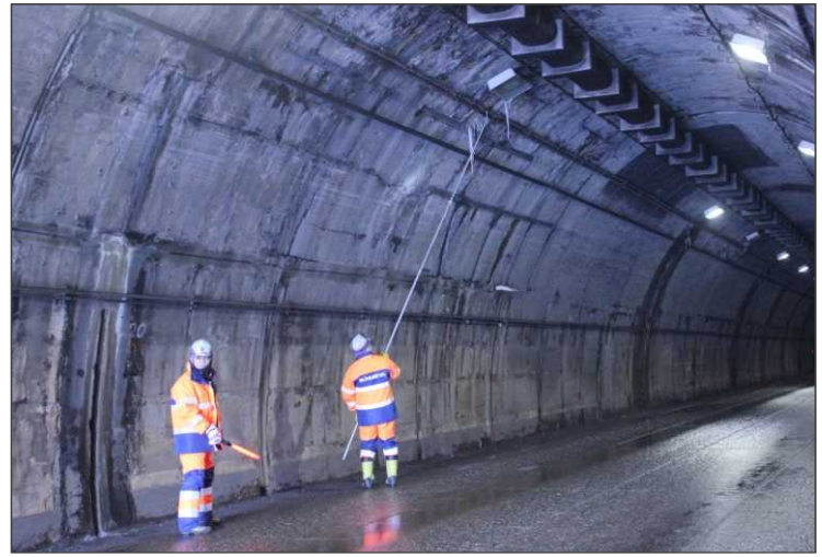
トンネル内の氷柱処理【国道17号 二居トンネル内】 (H28.2.26撮影)
