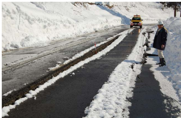
平成23年3月12日 路面陥没発生 (主)小千谷十日町津南線 津南町田中 (写真提供 新潟県)
