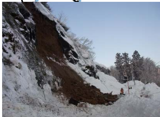
平成23年3月12日 雪崩発生 国道403号 十日町市孟地 (写真提供 新潟県)
