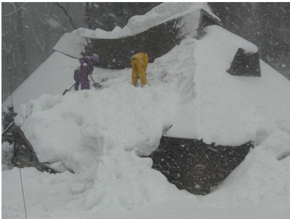
新潟県糸魚川市 雪の重みで家屋倒壊 写真提供: 糸魚川市 (H23.1.31撮影)
