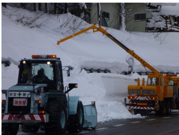
国道17号 新潟県湯沢町 雪庇処理 (H23.1.19撮影)
