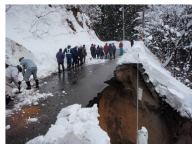
(一) 薦川中原線 路肩決壊発生 写真提供:新潟県 (H23.1.19撮影)
