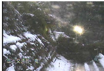
国道160号 七尾市庵町 法面崩落発生(H23.1.1撮影)
